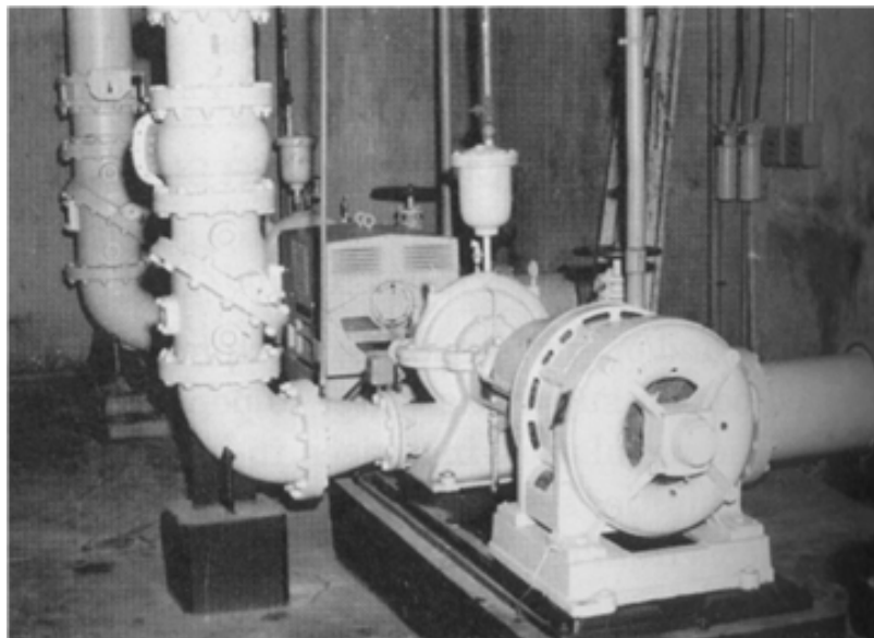
Pompa-pompa pada instansi pengelola air minum perkotaan.
